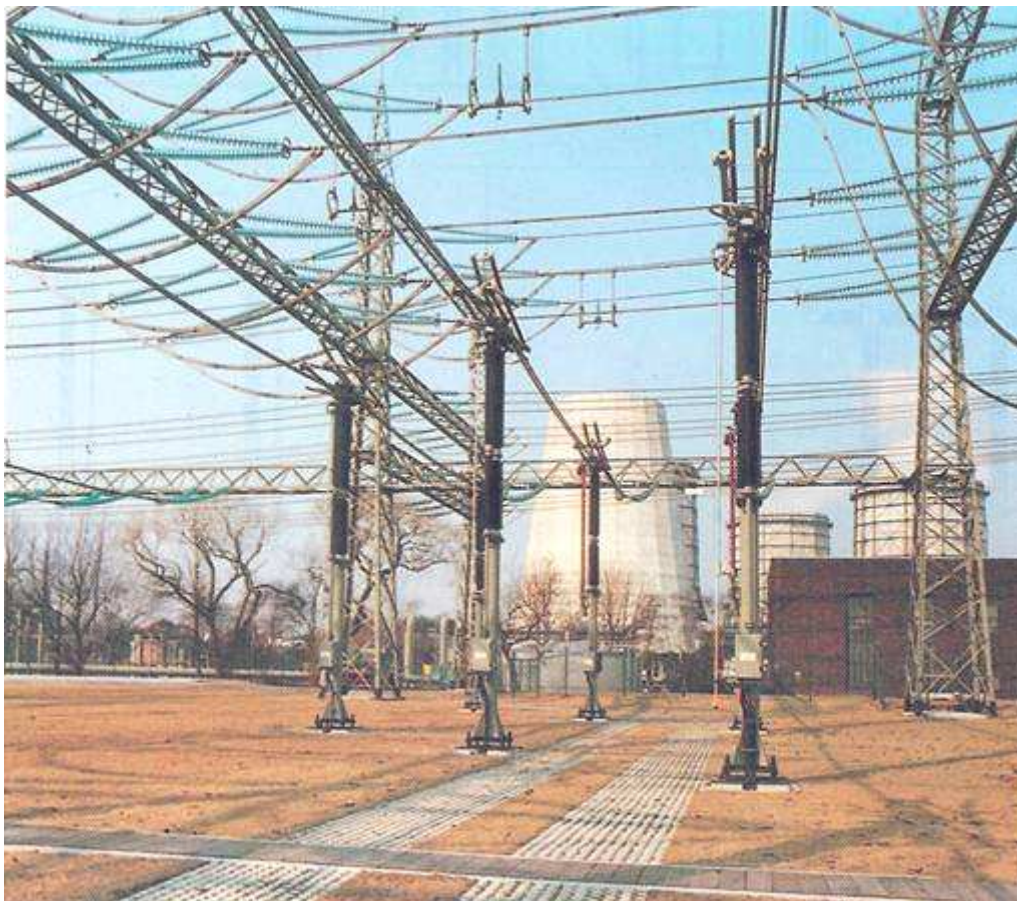
Obr. 15: tyčová zemnicí a zkratovací souprava u výkonového odpojovače ( vlevo ) a na vedení ( vpravo ) – možné uspořádání zemnicích tyčí v polích 420 kV
