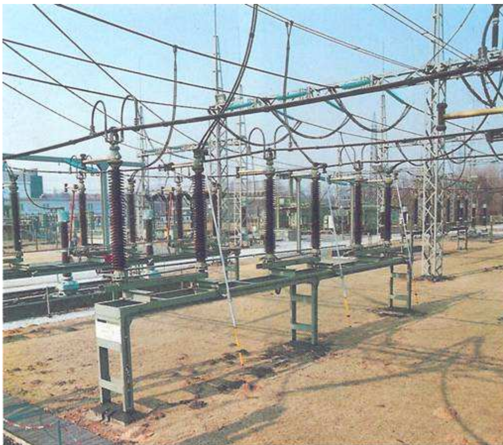
Obr. 16: zemnicí tyče v rozvodně 245 kV
